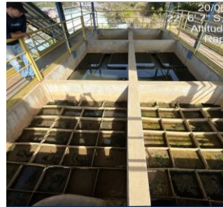
ETA Rua Direita
